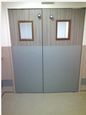
Contrôle de porte sur site
