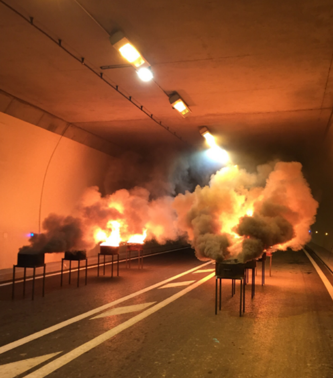
Essais du système de désenfumage, tunnel de Saint-Béat
