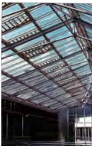
Exutoire de désenfumage à lamelles
